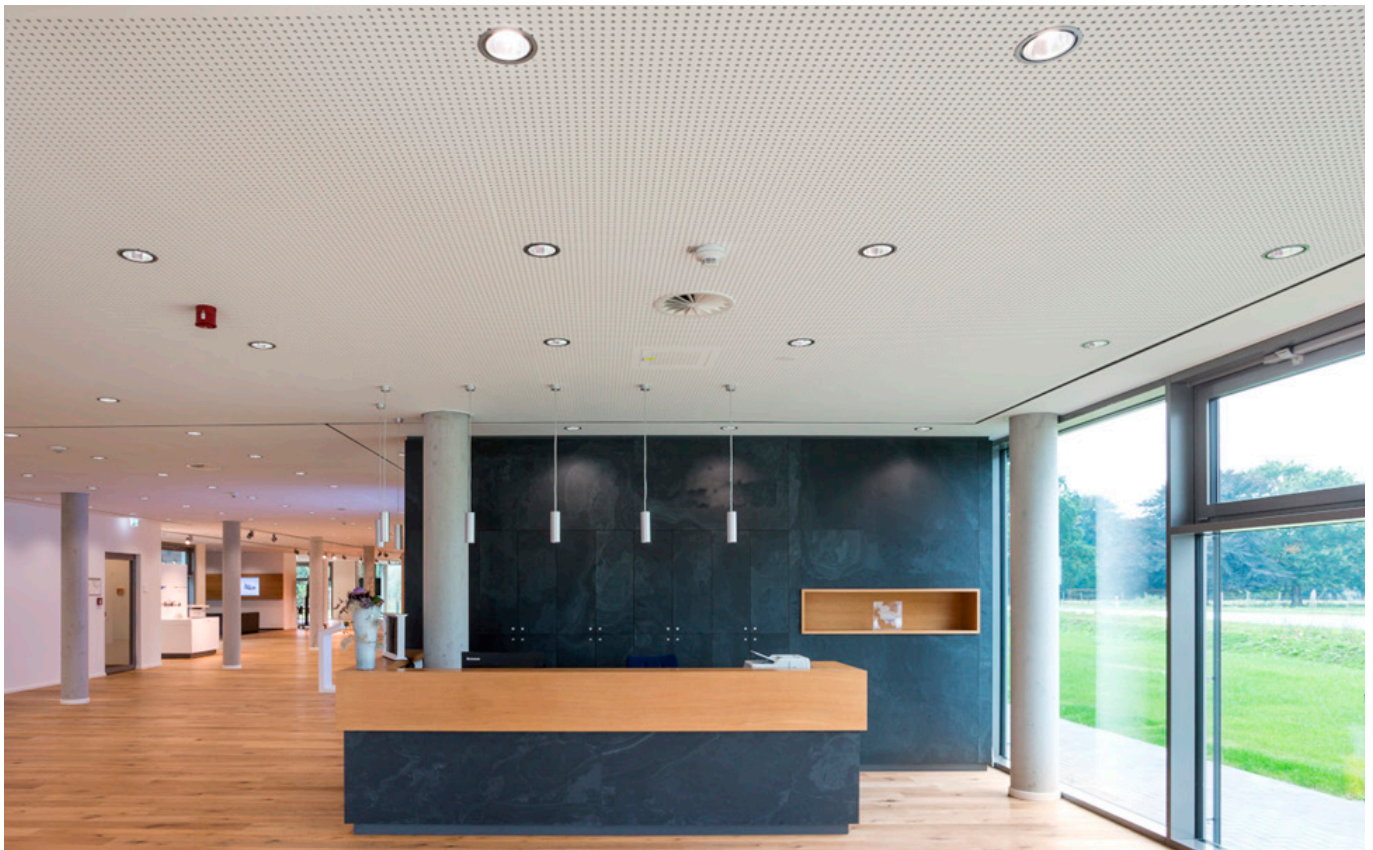
Abb. 7: Klimadecke mit gelochten Gipskartonplatten und diversen Einbauten (Licht, Luft, Sprinkler, Rauchmelder)
